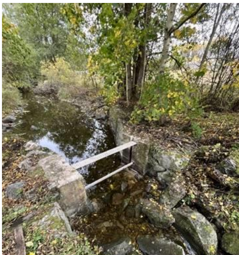
Figur 2. Vandringshinder vid Röby kvarn åtgärdat under hösten 2022. Stag uppsatta för att förhindra att fundament faller samman.
