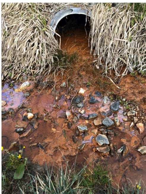
Dike, rostfärgat slam och oljeaktig hinna orsakat av järnbakterier
