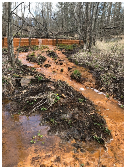
Dämme vid Okvista dagvattendamm med rostfärgat sediment orsakat av järnbakterier.
